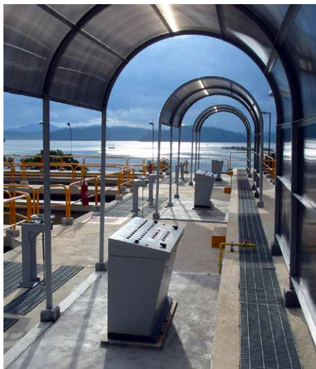
Fotos 20 e 21: Estação de tratamento de água da Prolagos em Juturnaíba. Fotos: acervo Prolagos.
